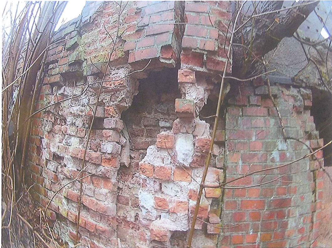
Fot. 1. Znaczne ubytki w konstrukcji ściany przyczółka
