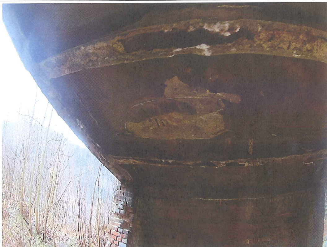
Fot. 3. Zaawansowana korozja oraz ubytek fragmentu dźwigara
