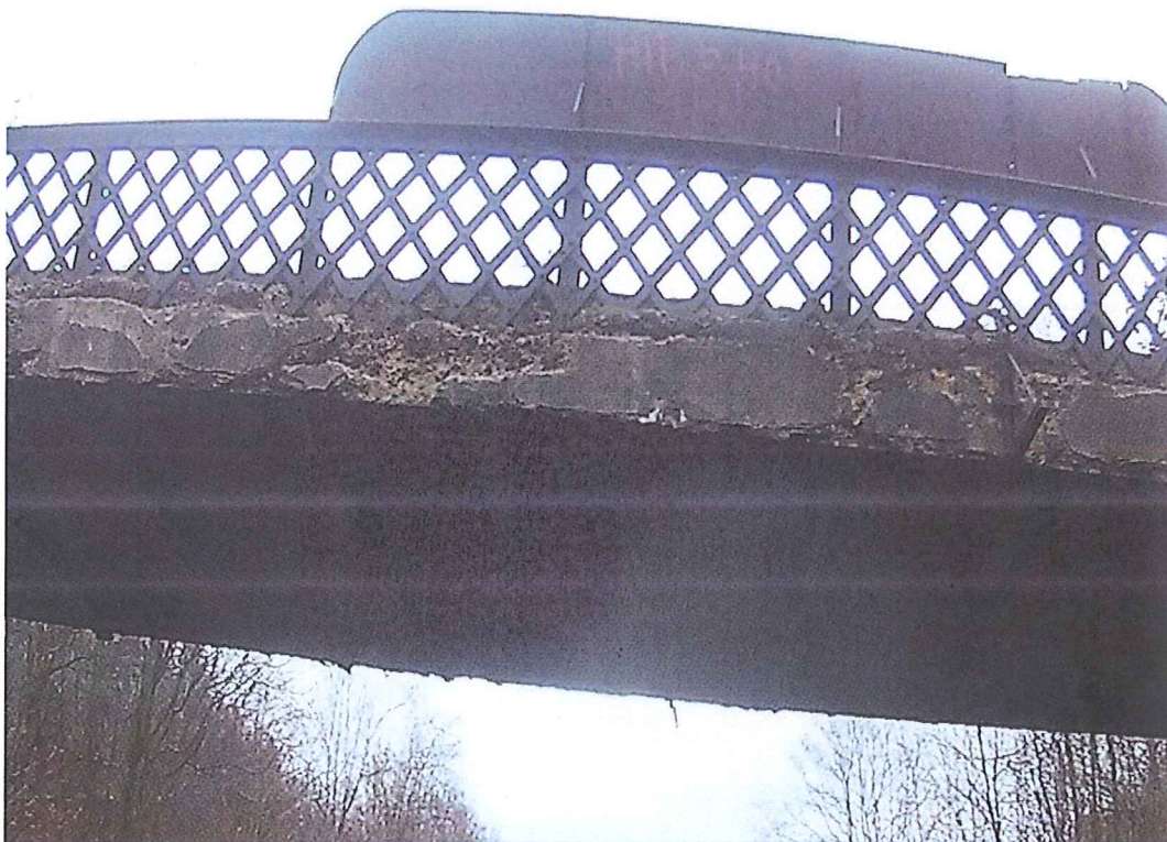
Fot. 2. Ubytki betonu w konstrukcji gzymsu
