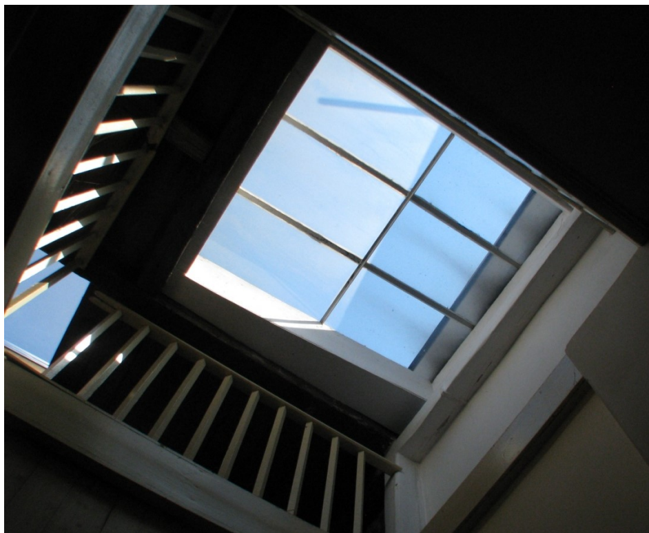
„Niewłaściwe” : świetlik i wyłaz dachowy – do wymiany
